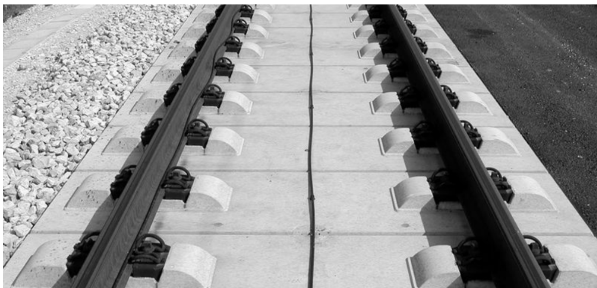
Rys. 1. Tor wyposażony w przewody transmisyjne systemu LZB [3]
